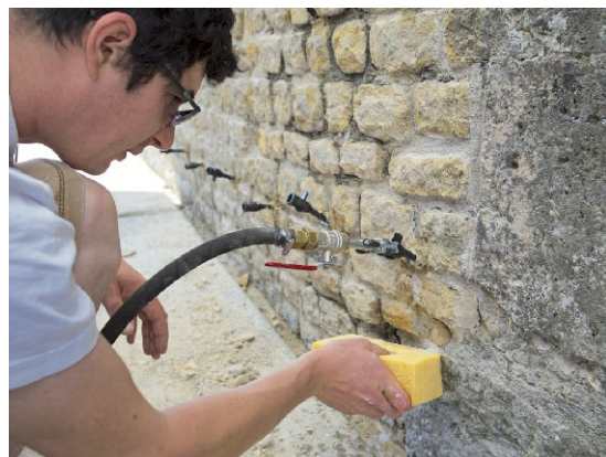
Fig. 21 – Noé Terrapon, responsable de la conservation-restauration des monuments d'Aventicum, procède à l'injection de mortier de chaux dans une maçonnerie antique
