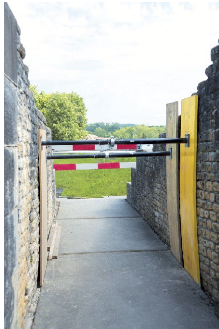
Fig. 20 – Le renflement des parements de mur dans le vomitoire 8 de l'amphithéâtre a nécessité une intervention urgente. Les parements encore en grande partie intacts ont dû être sécurisés et consolidés de façon à stopper la dégradation des maçonneries et à éviter tout danger d'effondrement pour les visiteurs
