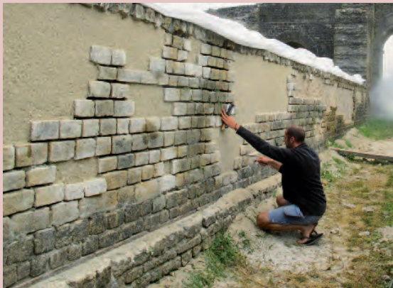
Abb. 123 – Stadtmauer. Der aktuelle Zustand der teilweise über 100jährigen Restaurierungen am Osttor erfordert Sicherungs- und Konsolidierungsmassnahmen des Mauerwerks.
