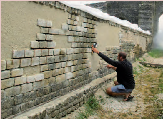
Fig. 123 – Mur d'enceinte. L'état de conservation actuel des restaurations réalisées il y a plus de 100 ans à la porte de l'Est impose des mesures de sécurisation et de consolidation des maçonneries.
